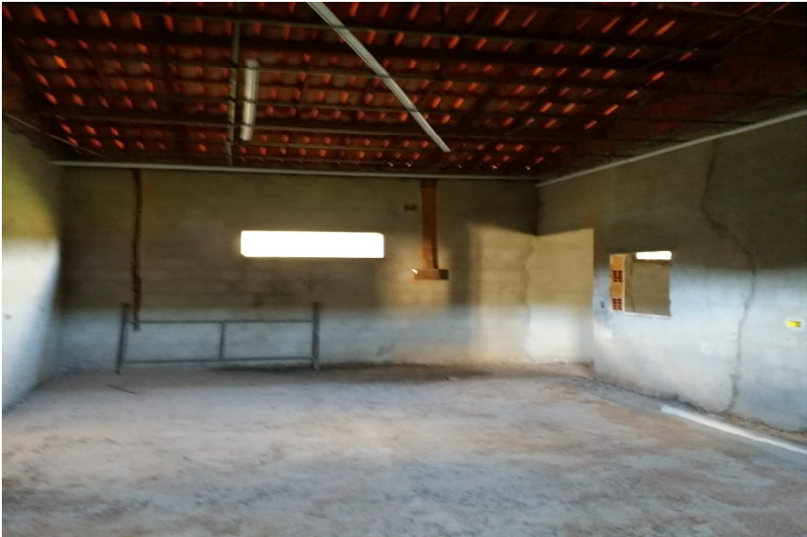
Figura 7: Sala de despulpamento e envase na Readequação da agroindústria
