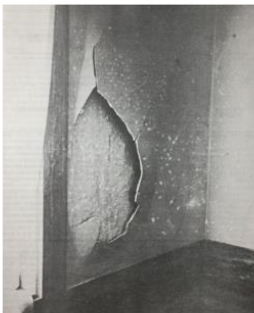
Figura 7 – Parede com descolamento do revestimento
