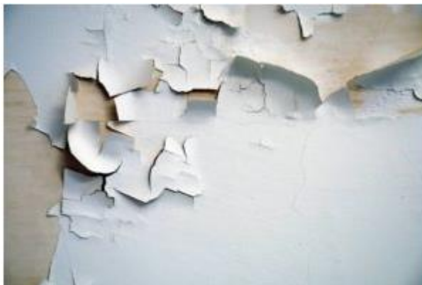
Figura 10 – Descascamento da pintura em uma parede
