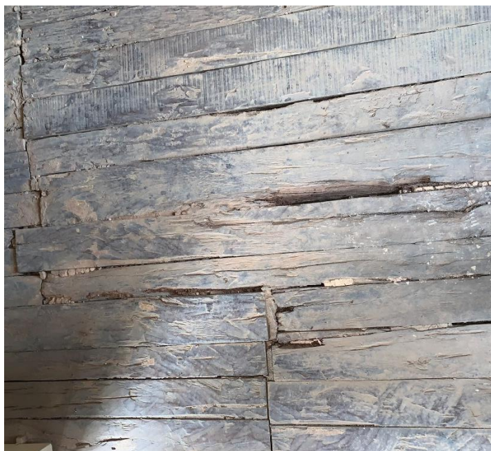
Figura 11 – Madeira do piso desgastada
