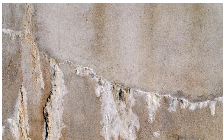
Figura 5 – Eflorescência em uma parede
