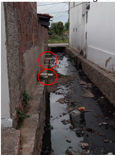
Figura 11 - Lançamento de efluente nas galerias de água pluvial.
