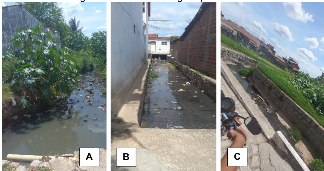
Figura 30 - Galerias de águas pluviais.
