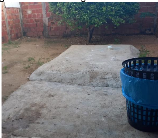
Figura 8 - Fossas negras em residências.
