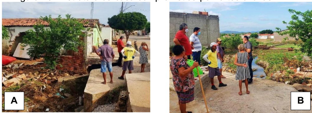
Figura 28 - Estrutura da casa comprometida por fortes chuvas.
