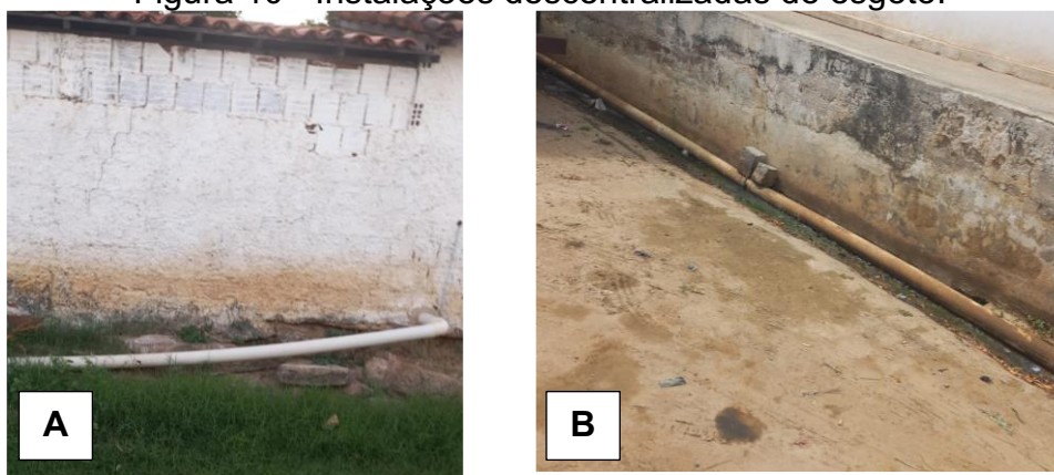
Figura 10 - Instalações descentralizadas de esgoto.
