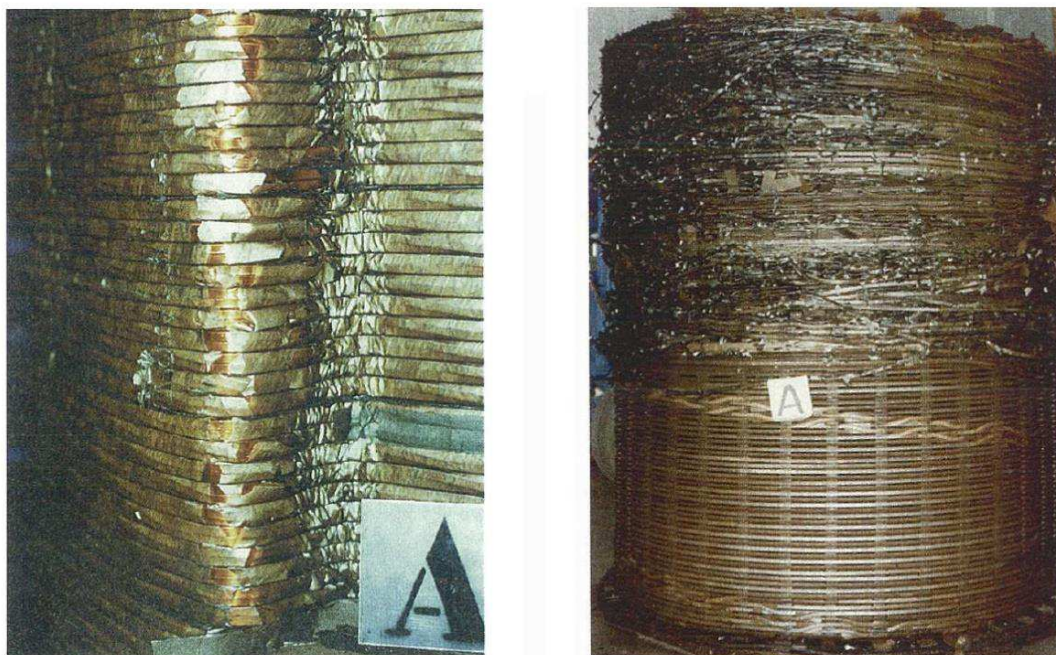
Figura 1 – Colapso de um enrolamento devido a forças radiais (a) e efeitos de curtos-circuitos interno causados por deterioração do isolamento (b).
