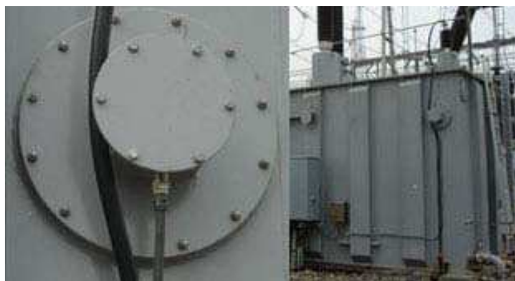
Figura 3.16 – Fotografia de um sensor UHF montado no tanque de um transformador de 360 MVA.
