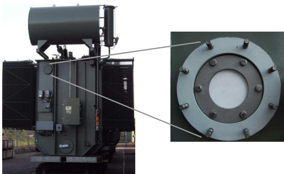
Figura 2.9 – Transformador de 90 MVA equipado com janela dielétrica.
