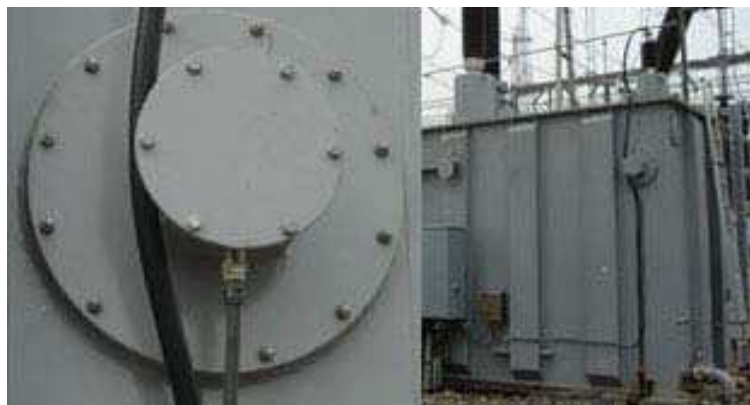
Figura 2.10 – Sensor UHF montado no tanque de um transformador de 360 MVA.
