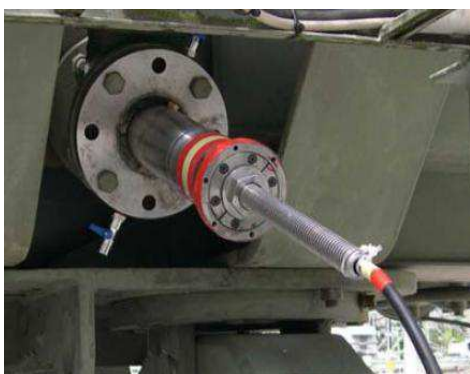
Figura 3.11 – Fotografia de um sensor UHF sonda portátil instalado através da válvula de óleo de transformadores de 200 MVA e 380/220 kV.
