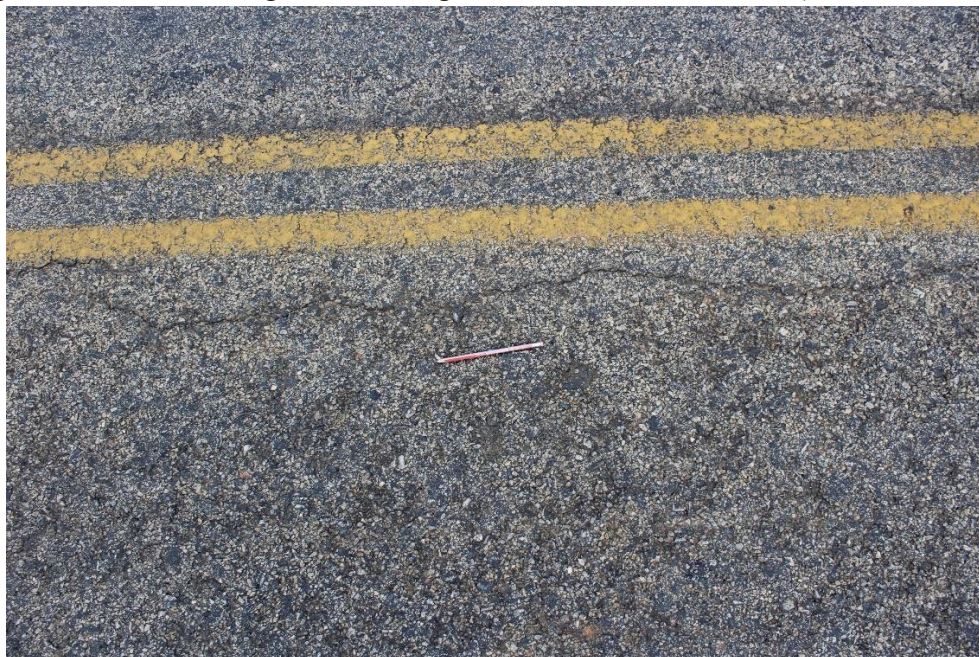
Figura 26 – Trinca Longitudinal Longa na Estadual Coincidente (PB-306/BR-426).
