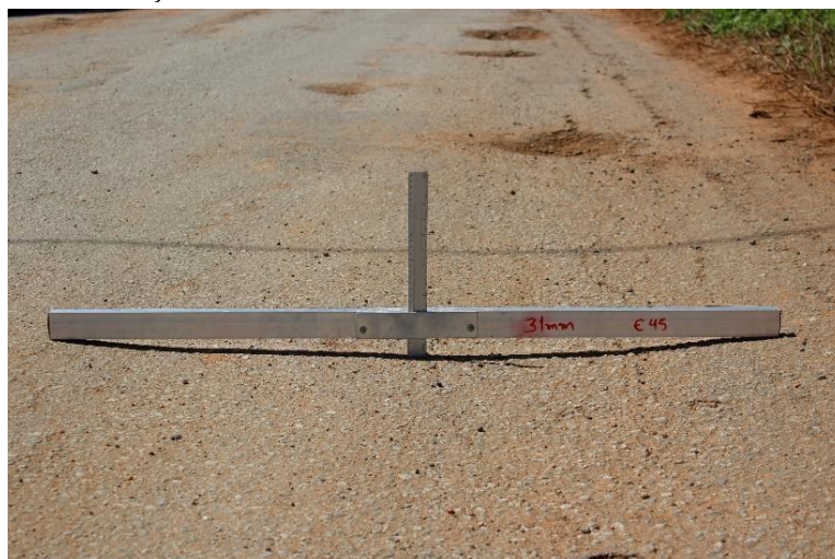
Figura 14 – Medição de afundamento de trilha de roda externa na PB-306.
