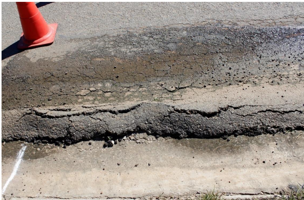
Figura 23 – Escorregamento junto de Trinca tipo Jacaré e de Afundamento de Trilha.
