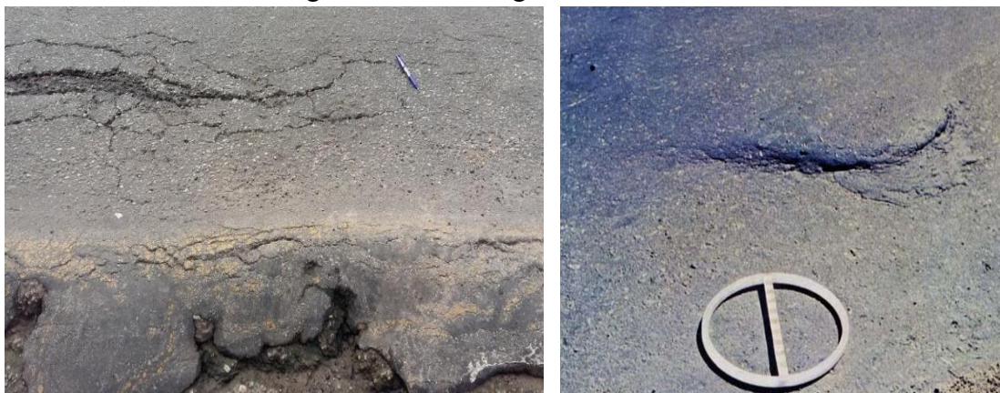
Figura 08 – Escorregamento de massa.
