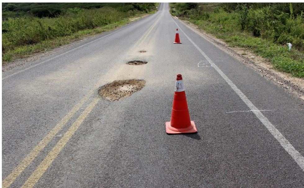
Figura 25 – Presença de Panelas no final do Trecho B.
