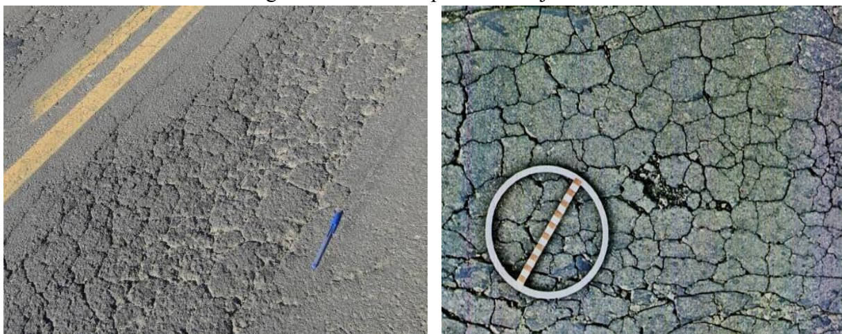
Figura 04 – Trinca tipo couro de jacaré.
