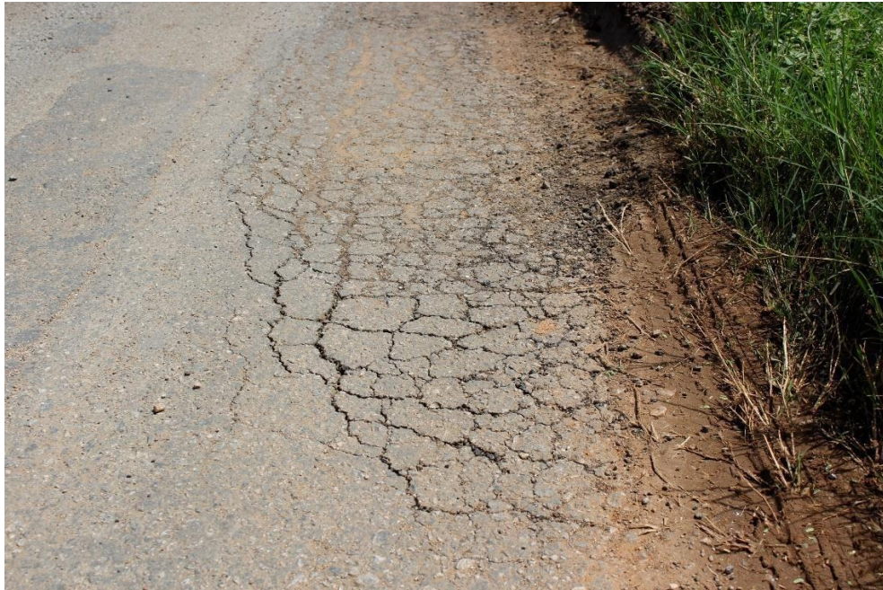
Figura 22 – Trinca Interligada do tipo Jacaré.
