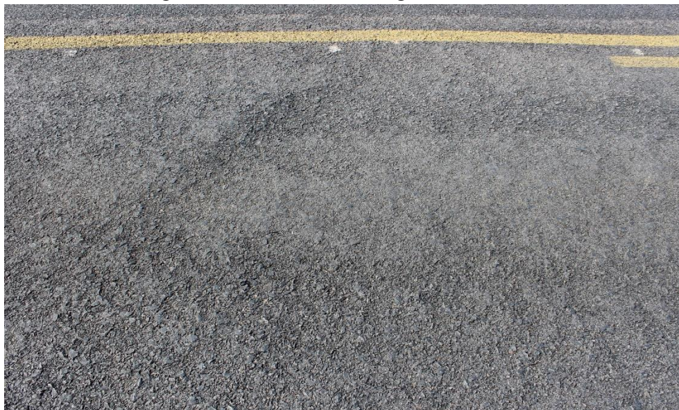
Figura 24 – Presença de Desgaste na BR-426.
