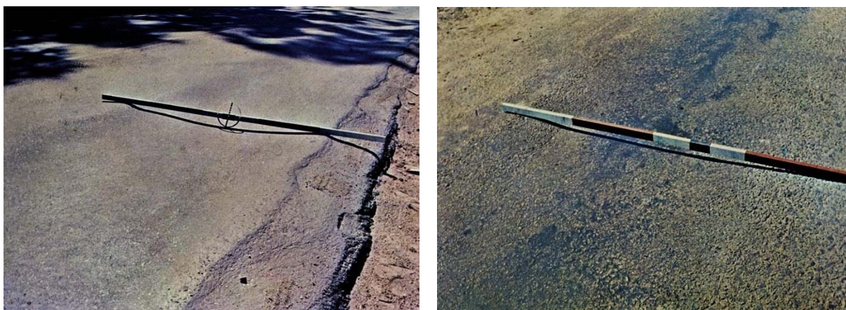
Figura 06 – Afundamento Plástico e Afundamento de Consolidação.
