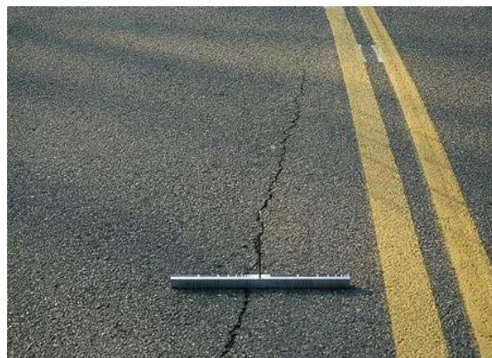
Figura 03 – Trinca longitudinal longa.
