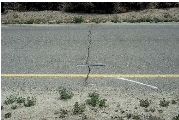
Figura 02 – Trinca transversal longa.
