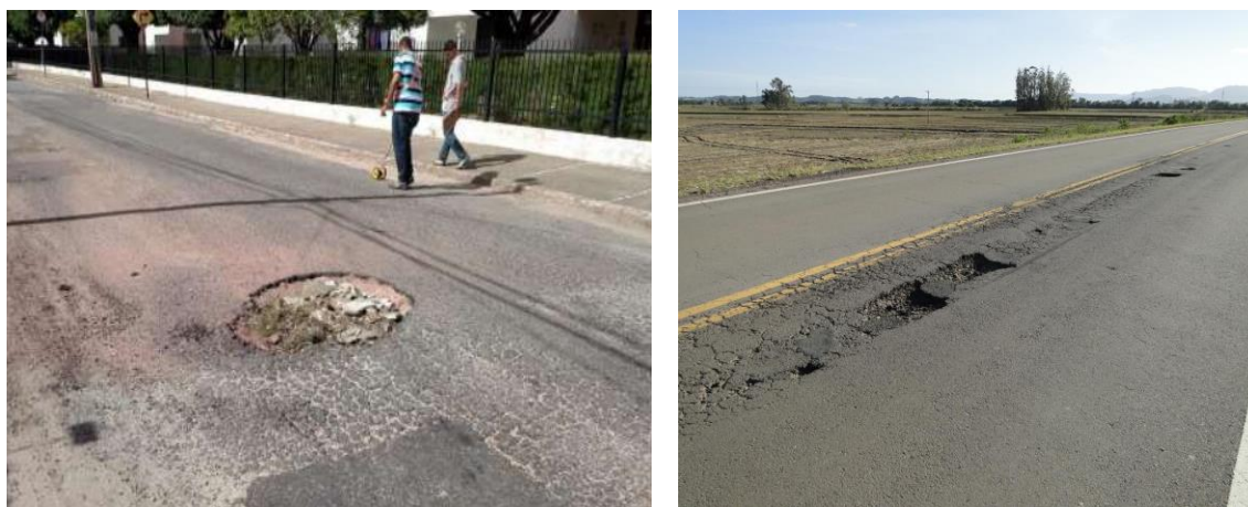
Figura 11 – Painelas ou buracos.
