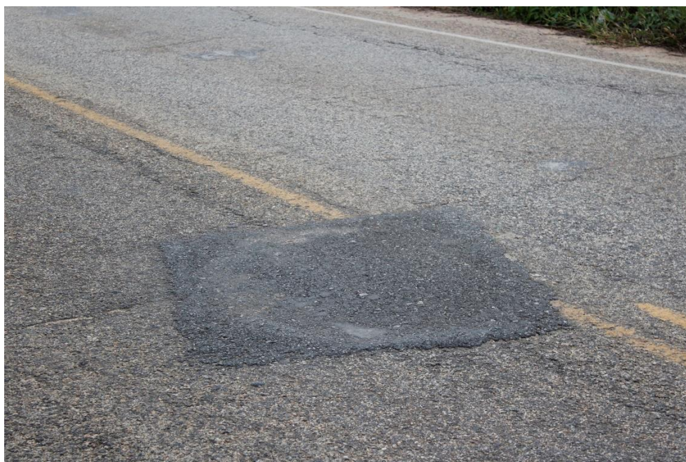
Figura 27 – Presença de Remendo na Estadual Coincidente (PB-306/BR-426).
