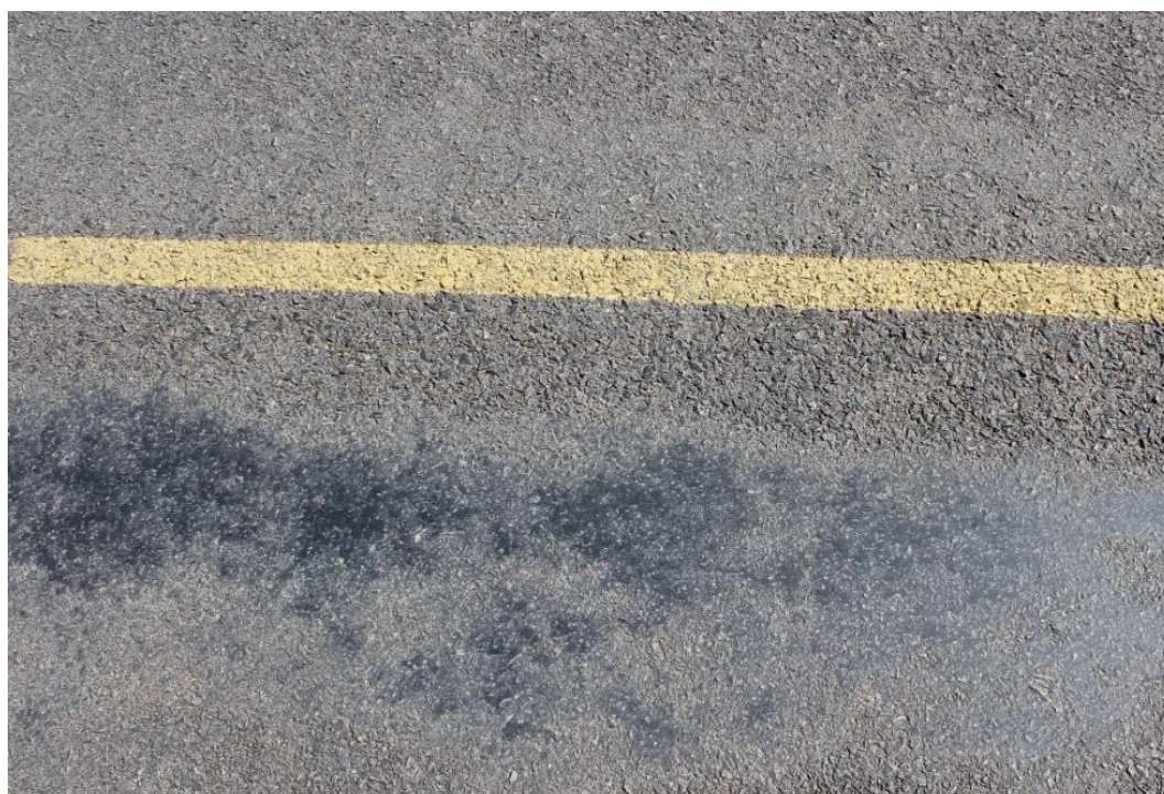
Figura 28 – Presença de Exsudação na BR-426.
