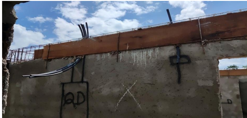
Figura 13 - Passagem dos eletrodutos pela viga antes da concretagem em uma construção de uma creche em Pombal -PB.
