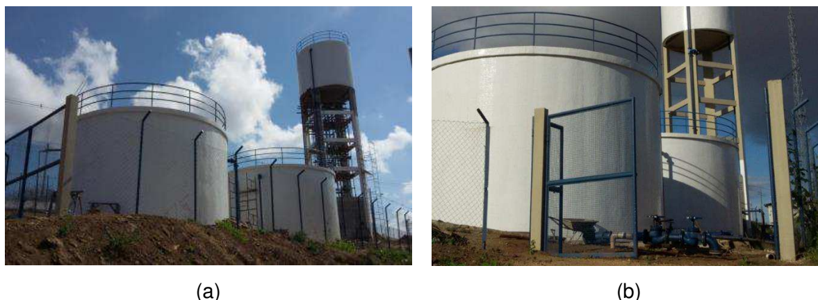
Figura 17 - Posicionamento dos reservatórios do sistema (a) e o conjunto motobomba (b)
