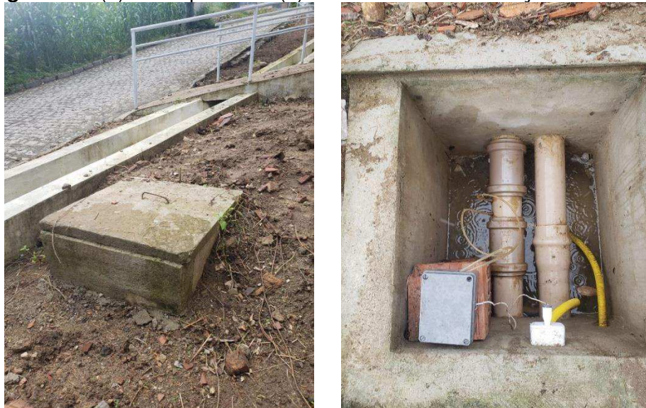
Figura 21 - (a) Caixa protetora (b) Sistema de macromedição instalado
