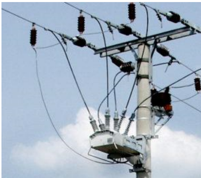
Figura 4 - Religador sendo aplicado em uma rede elétrica.
