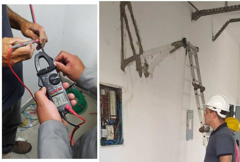
Figura 30 – Teste em string e análise da interligação do sistema com o QDC.
