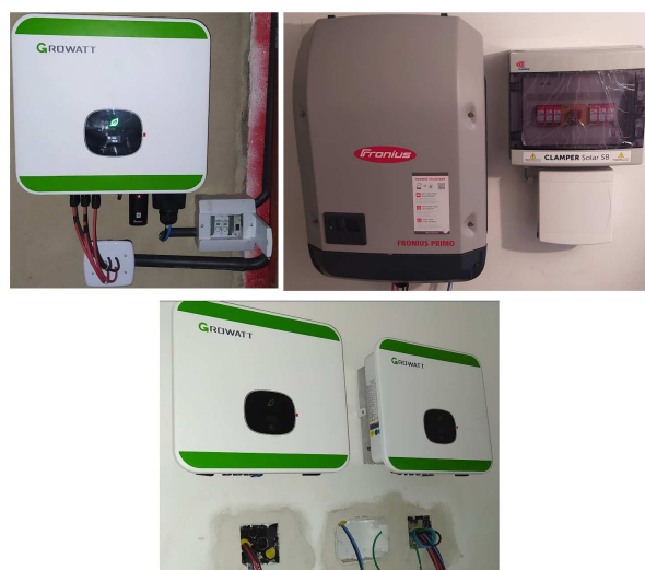
Figura 29 – Inversores instalados em obras visitadas.
