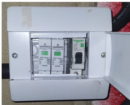
Figura 23 – Dispositivos de proteção CA implementados no sistema fotovoltaico.
