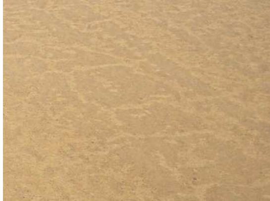
Figura 12 - Fissuras em rodovias construídas com solos lateríticos finos
