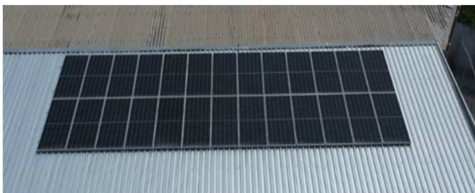
Figura 18: Painéis Solares Instalados no Local do Estudo de Caso.
