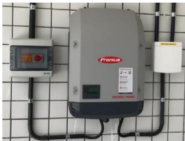
Figura 19: Equipamentos da Unidade Geradora Fotovoltaica.
