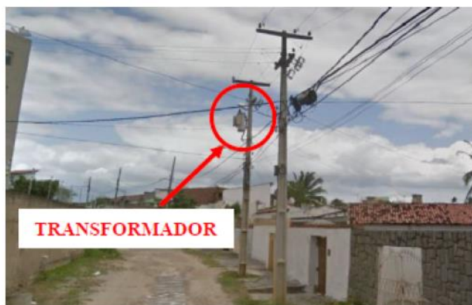
Figura 20: Transformador abaixador da rede de distribuição de energia elétrica no local do estudo de caso.
