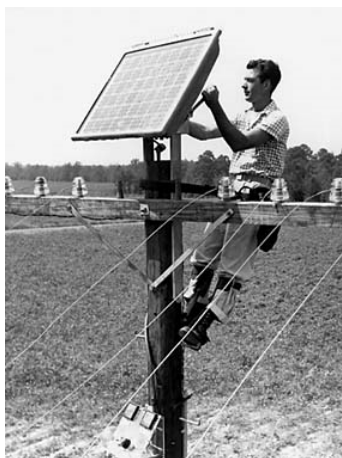
Figura 2.3 – Instalação de células de Silício à rede telefônica.
