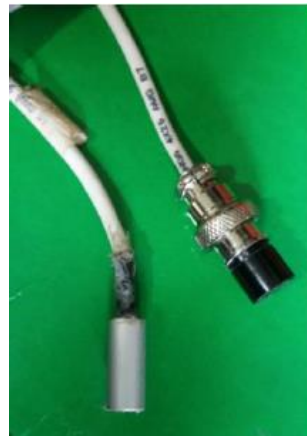
FIGURA 9 - CABOS E CONECTORES
