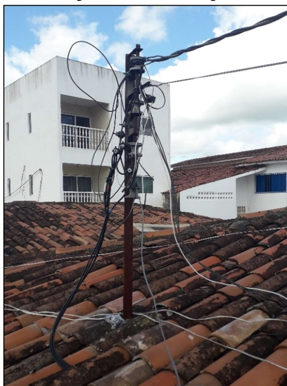
Figura 14: Entrada de energia.
