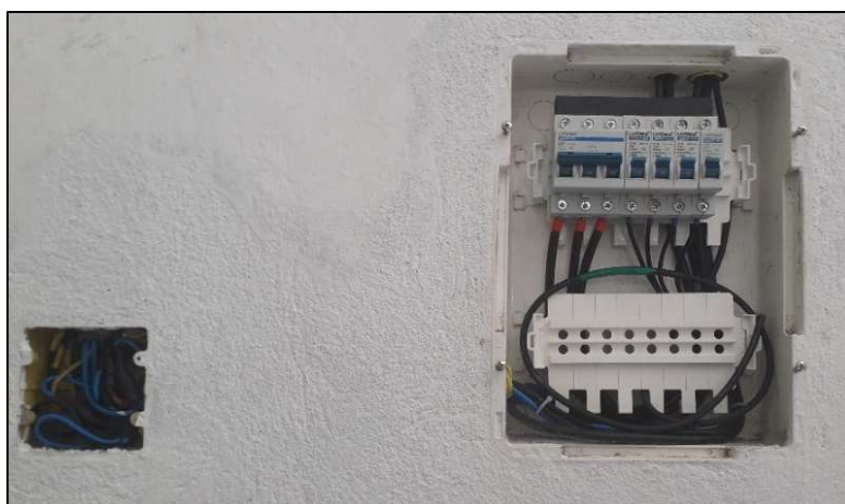
Figura 9: Quadro geral de distribuição (QGD) e caixa de passagem após a reforma.
