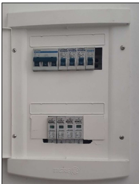
Figura 10: Quadro de distribuição finalizado.
