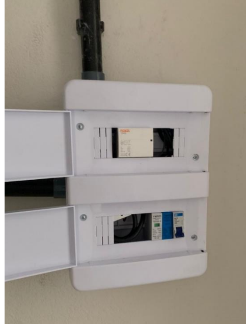
Figura 18 - Quadro de proteção CA.
