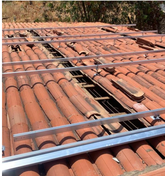
Figura 15 - Estrutura suporte para os módulos.
