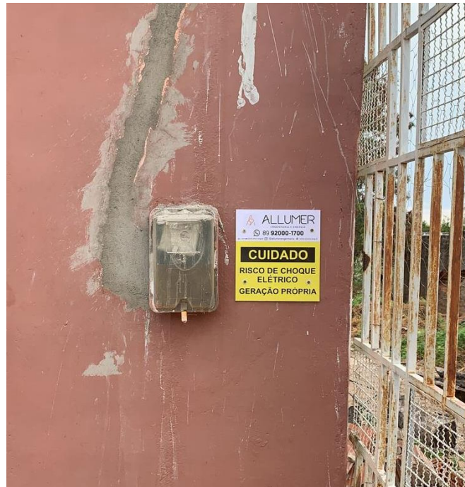
Figura 20 - Placa de advertência junto à medição.
