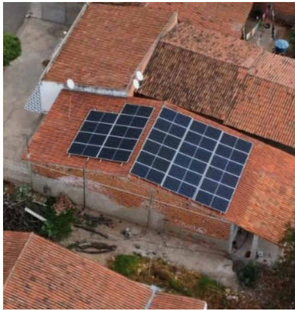
Figura 13 - Telhado da residência com sistema fotovoltaico On-grid .
