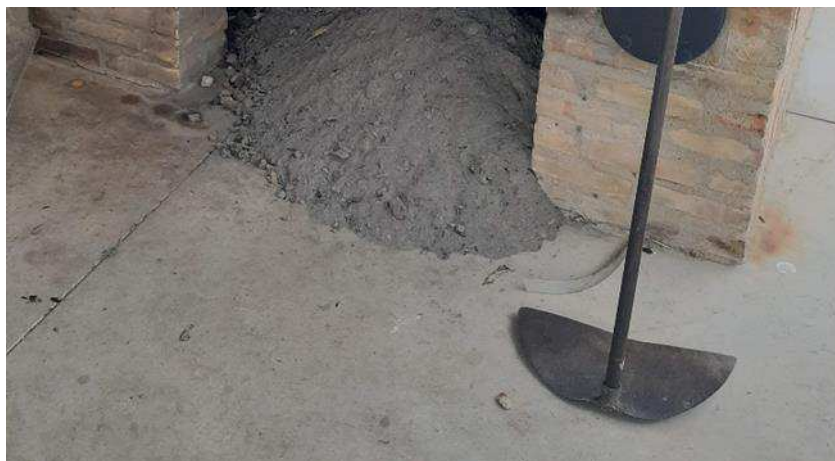
Figura 14: Cinza do bagaço da cana de açúcar no fundo da caldeira
