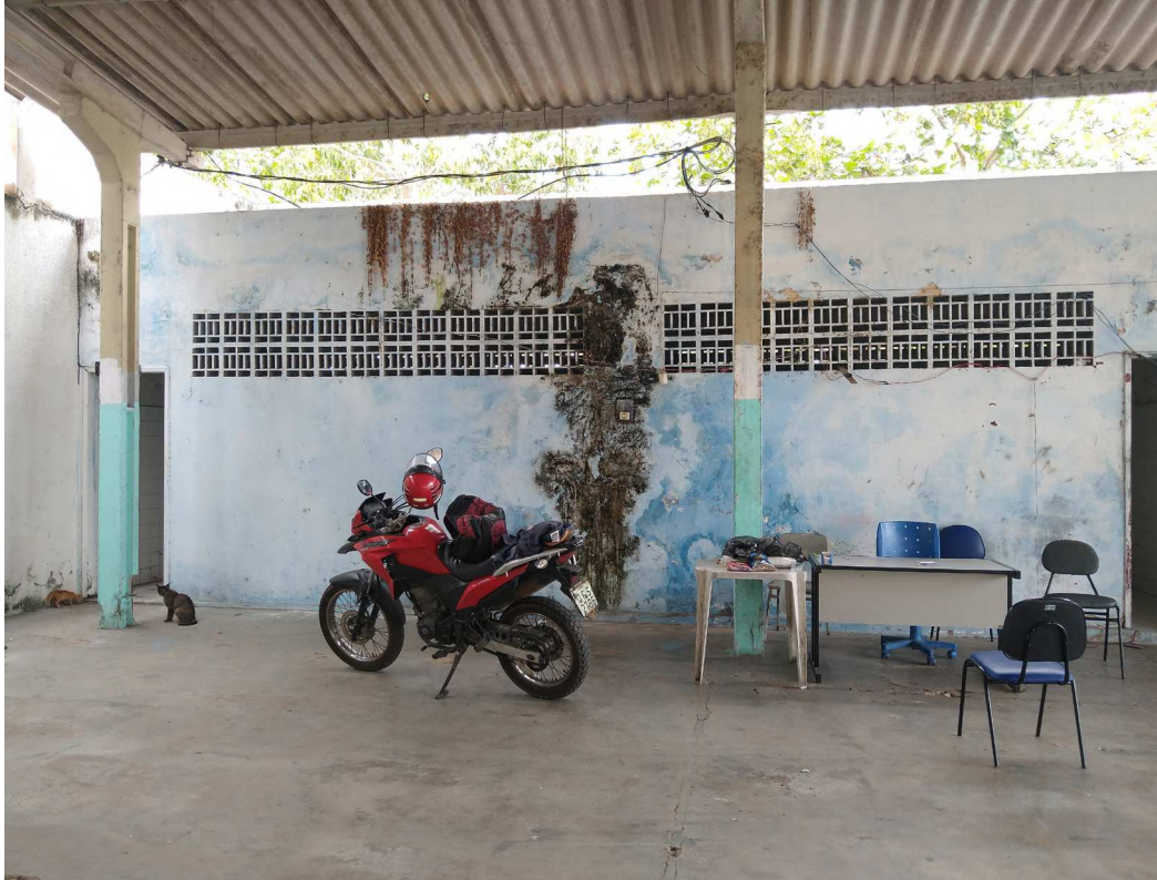
[FIGURA 75] MOFO NAS VEDAÇÕES EXTERNAS DOS BANHEIROS, E PRESENÇA DE ELEMENTOS VAZADOS. A ESTRUTURA DESSE VOLUME É AUTOPORTANTE. FONTE: ACERVO PESSOAL, 2021.
