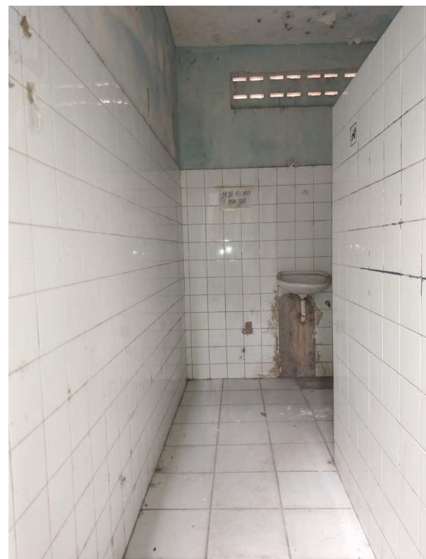
[FIGURA 73] DESTACAMENTO DE REVESTIMENTOS NAS VEDAÇÕES DO BANHEIRO.
