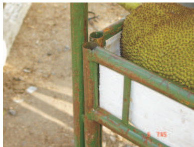
Fig. 08 Ferrugem nos tubos e PVC desgastado.
