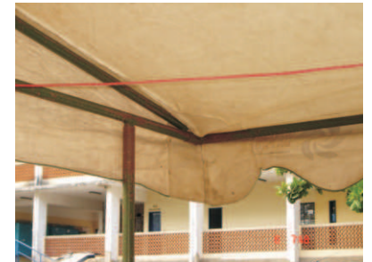
Fig. 10 Lona desgastada e ferrugem no teto.
