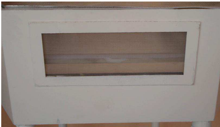
Figura 53 - Abertura para entrada de ar
