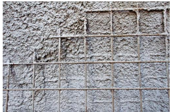
Figura 43: Estrutura com estribos
