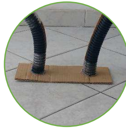
Figura 79: Alteração no formato da base.
