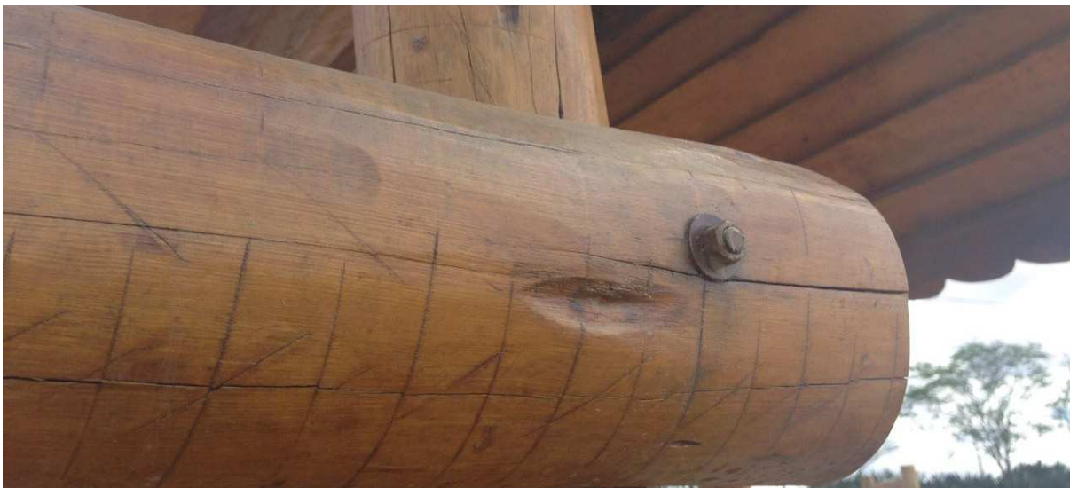
Figura 41: Parafuso instalado incorretamente
