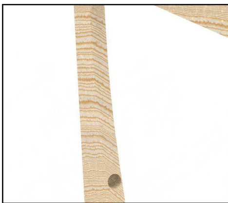
Figura 39: Orifício na estrutura Fonte: do autor, 2018
