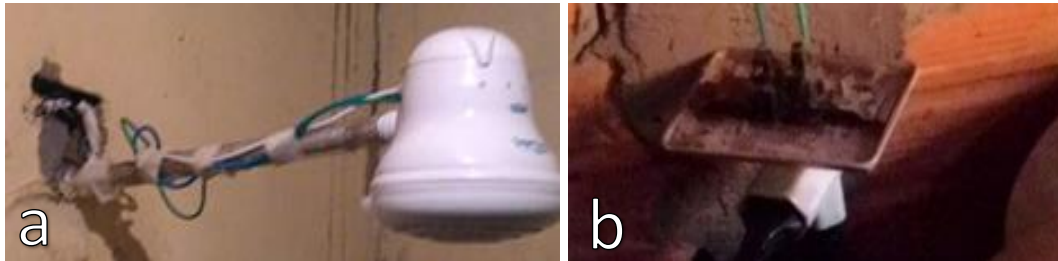
Figura 6. (a) Chuveiro instalado irregularmente, (b) Interruptor de luz não afixado corretamente.
