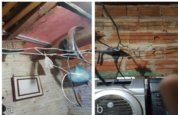
Figura 7. (a) Fios diferentes e sem isolamento, (b) Fios sem isolamento.
