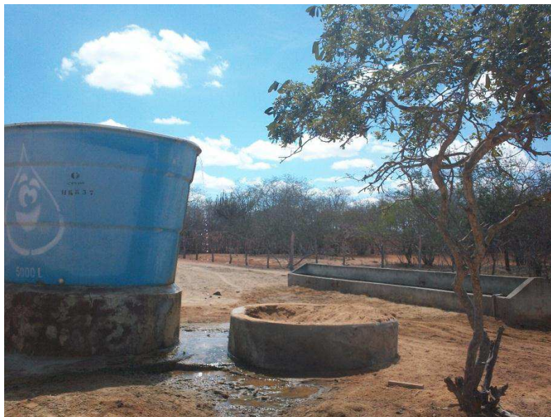
Figura 22: Água extravasando da caixa d'água
