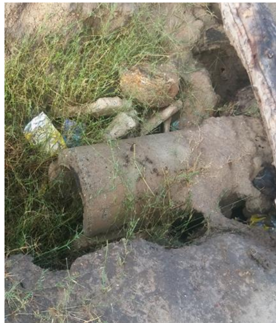
Figura 10. Tubulação de esgoto.
