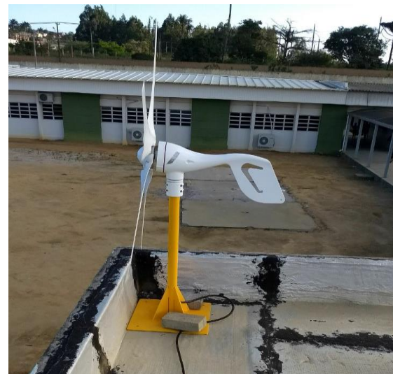
Figura 10 (b). Aerogerador instalado.
