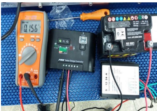
Figura 10 (a). Conjunto conversor CA/CC + controlador de carga + bateria.
