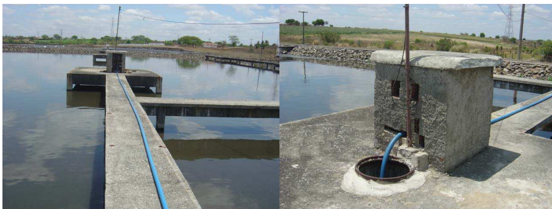
Figura 2. Captação do efluente final das lagoas de estabilização usado no experimento, ETE de Campina Grande.
