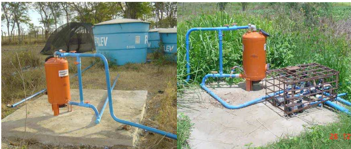
Figura 4. Cabeçal de controle composto por filtro de areia, motobomba, filtro de disco, filtros de tela e manômetros analógicos.
