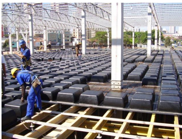
Figura 13 - Cubas apoiadas em vigas metálicas
