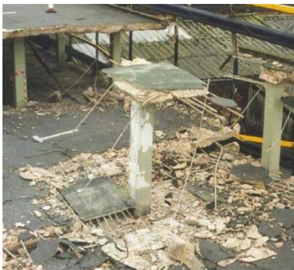
Figura 11 – Ruína por punção
