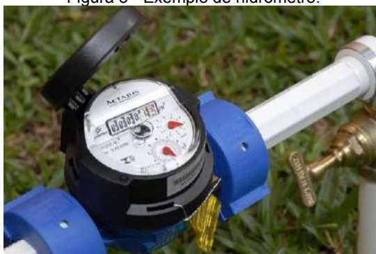
Figura 5 - Exemplo de hidrômetro.
