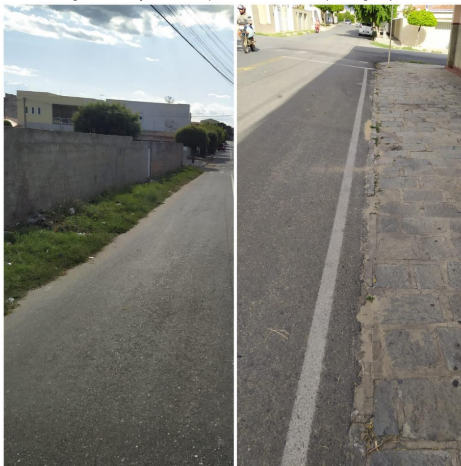
Figura 8 - Sarjetas inadequadas e obstruídas por vegetação
