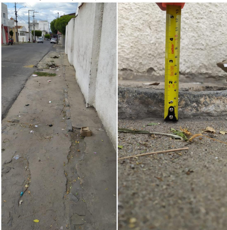
Figura 7 - Sarjeta em processo de erosão e assoreamento
