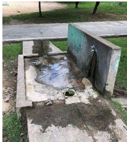
Figura 31 - Vazamento de água
