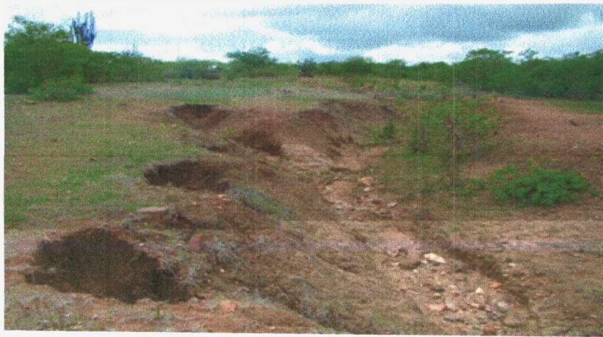
Figura 05 – Ravina causada pelo escoamento concentrado d'água
