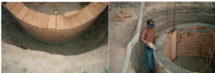
Figura 4. Alvenaria sem rejuntamento. Cinta de amarração.
