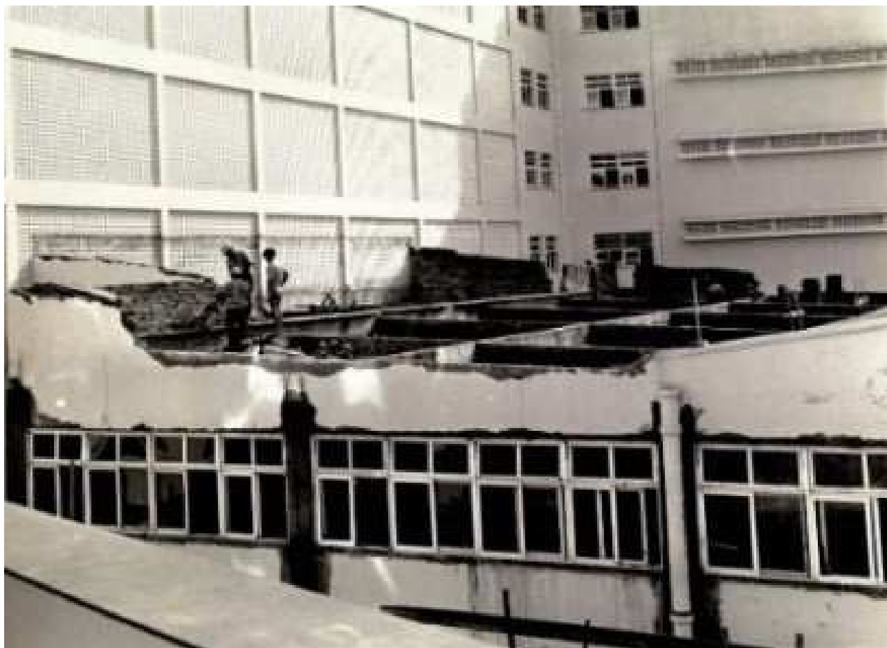
Vista externa da área do refeitório em obras. Fonte: Acervo fotográfico da Biblioteca do HUIBB, s/d
