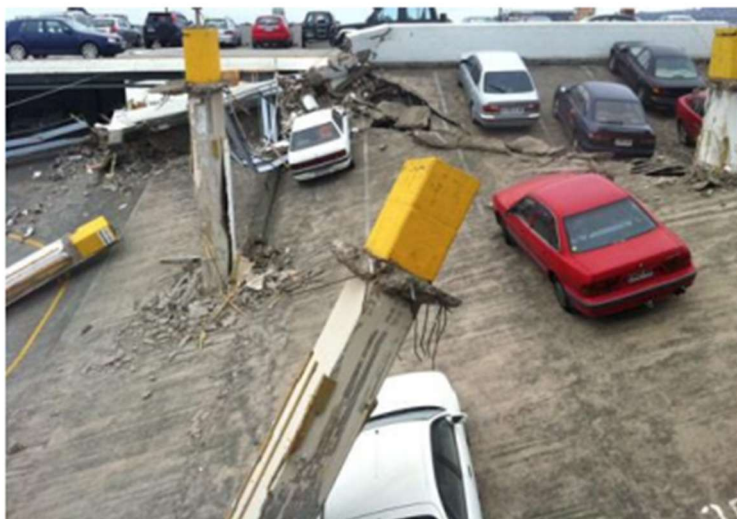
Figura 2- Colapso de laje protendida na Nova Zelândia. (Middleton, 2013)
