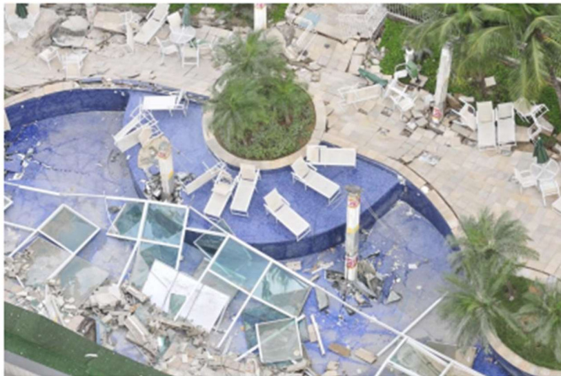
Figura 3- Colapso de área de lazer de condomínio residencial. (Gazeta, 2016)
