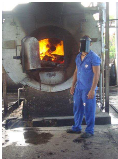
Figura 4 – Operador de caldeira sem os EPI's recomendados.
