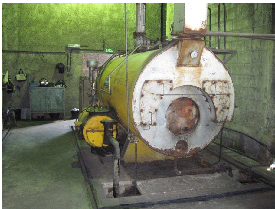
Figura 2 – Caldeira a óleo em local fechado.
