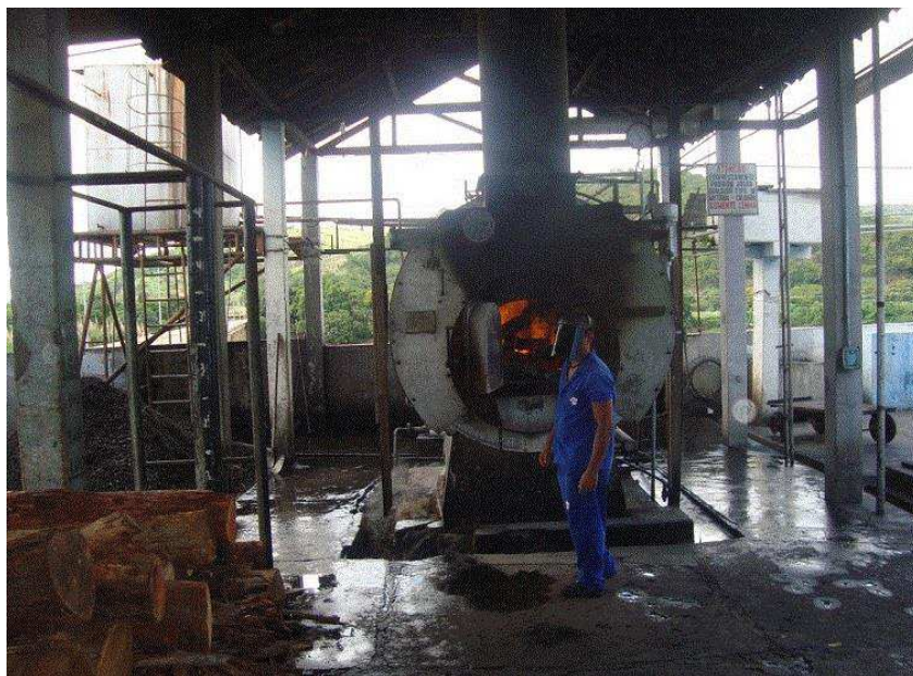
Figura 1 – Caldeira a lenha em local aberto.
