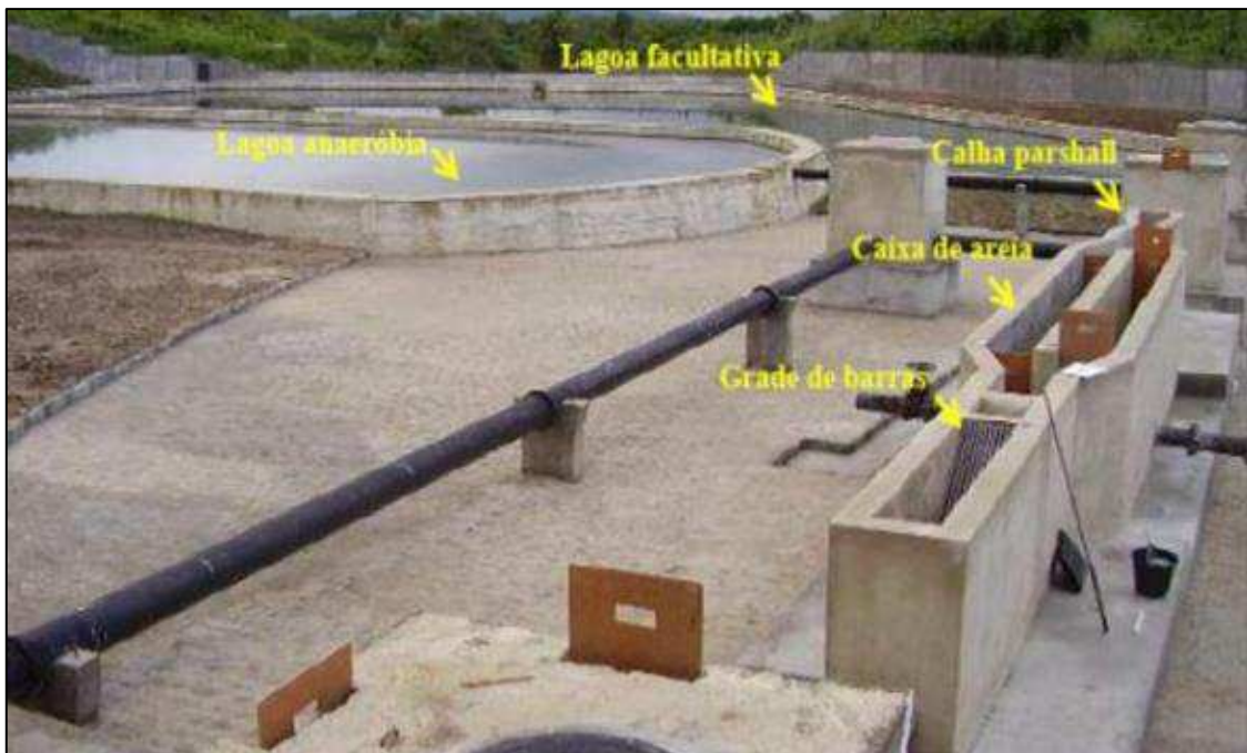
Figura 9 - Vista geral das unidades de tratamento da ETE do Glória recém-construída após 2006
