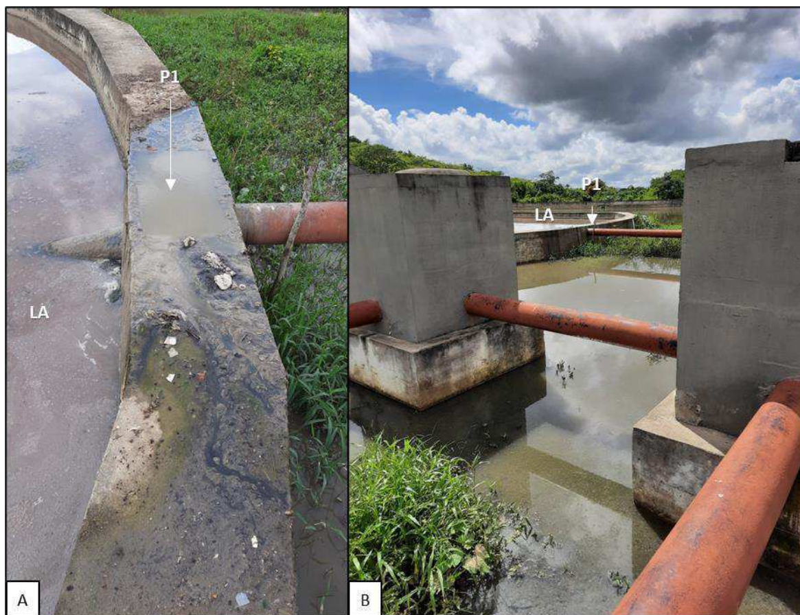
Figura 58 - Extravasamento de esgoto bruto na ETE em 2021. A) Tubulação entupida na entrada da LA. B) Esgoto bruto a céu aberto
