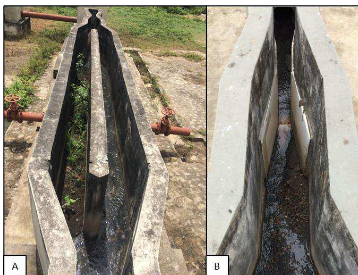
Figura 35 - Assoreamento identificado na A) Caixa de areia e B) Calha Parshall da ETE do Glória
