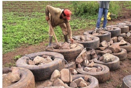
Figura 10. Visualização dos pneus de apoio (face jusante) para “amortecer” a passagem das águas.
