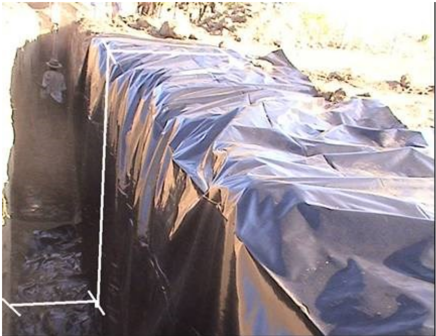
Figura 5. Altura da vala determina a lona com largura adequada a tal profundidade.
