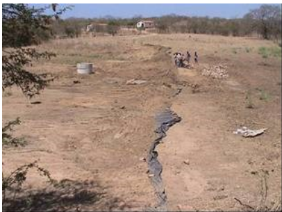
Figura 10. Aspecto geral da obra de barramento com lona plástica e poço a montante.
