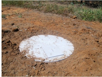
Figura 9. Tampa de concreto (pré-moldado).
