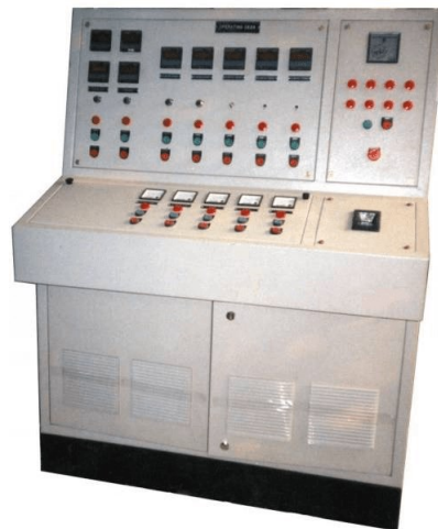
Figura 23 - Painel Elétrico Tipo Mesa de Comando
