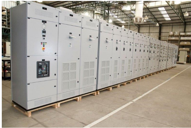
Figura 22 - Painel Elétrico Tipo Multicolunas
