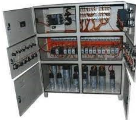
Figura 25 - Painel Elétrico Tipo Multimodular
