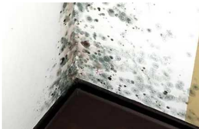
Figura 1 - Bolor em alvenaria
