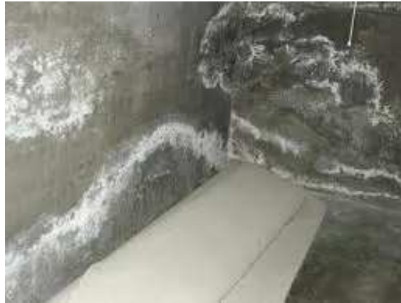
Figura 2 - Eflorescência em Alvenaria
