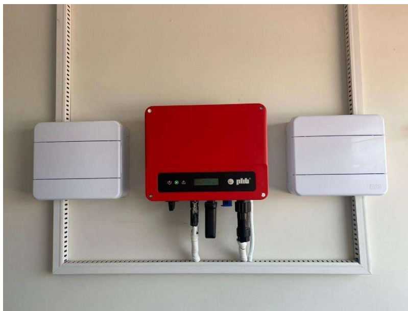
Figura 18 – Inversor Solar Instalado na Residência.
