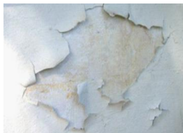
Figura 17 - Descascamento da pintura
