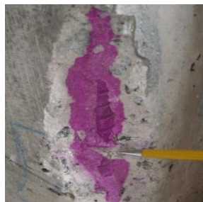
Figura 11 - Cor magenta, concreto sem carbonatação
