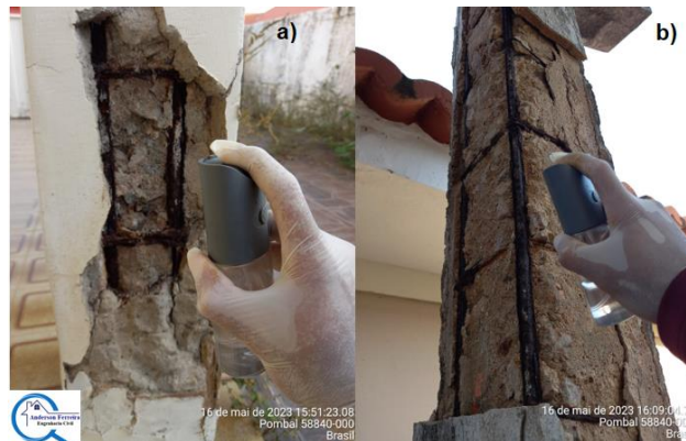
Figura 24 - Aspersão de fenolftaleína: a) P02 b) Pilar P11
