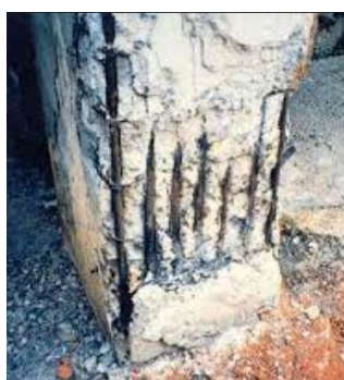
Figura 14 - Corrosão de armaduras
