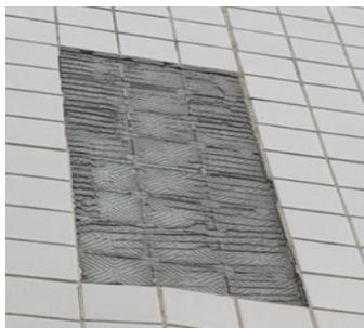
Figura 18 – Deslocamento ocasionado pelo não rompimento dos cordões de argamassa.
