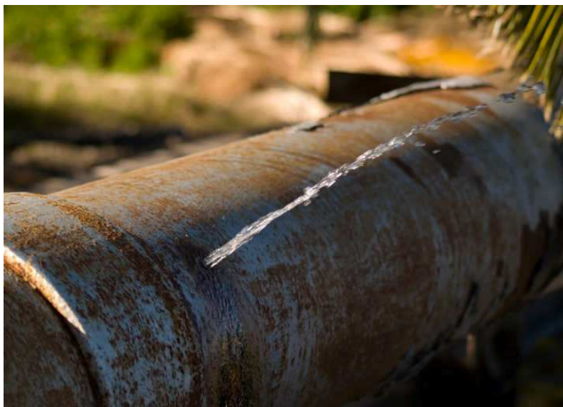
Figura 2.3: Tubulação com pequeno vazamento
