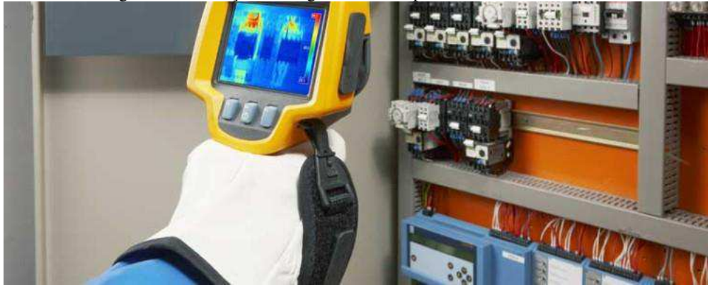
Figura 31 - Medição termográfica em dispositivos eletroeletrônicos
