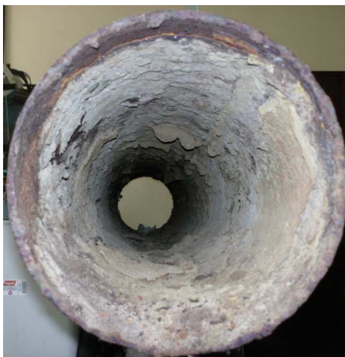
Figura 6.39: Fotografia do interior da tubulação com diferentes níveis de incrustação.
