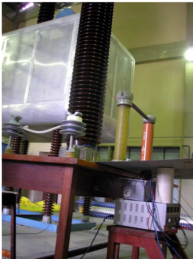
Figura 5.11.6 – Sensor utilizado nas medições da corrente de fuga na base do pára-raios.
