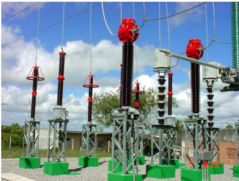
Figura 5.5.3 – Pára-Raios de ZnO, Transformadores de Potenciais e de Correntes
