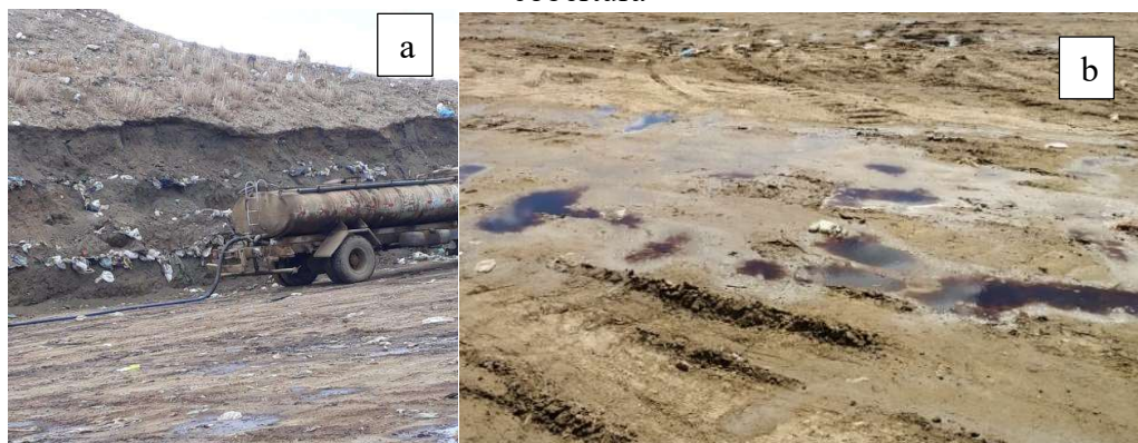
Figura 21 – (a) recirculação de lixiviado: carro pipa; (b) lixiviado empoçado na camada de cobertura
