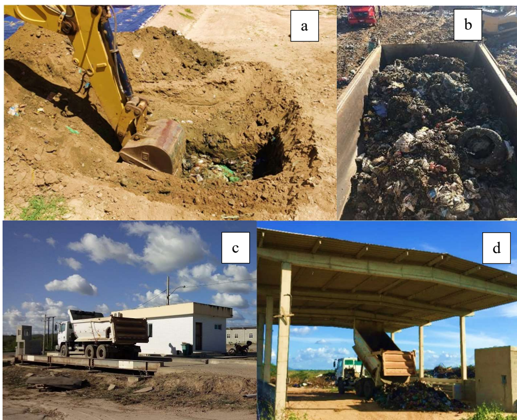
Figura 15 - (a) coleta; (b) resíduos acondicionados no caminhão caçamba; (c) pesagem dos resíduos; (d) disposição dos resíduos no galpão
