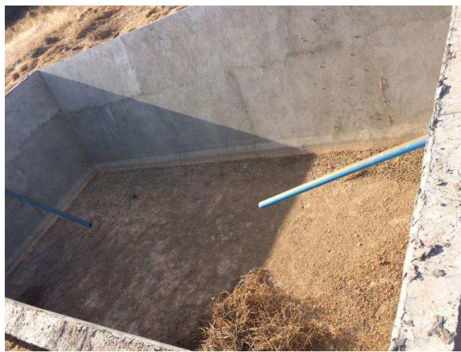
Figura 22- Tanque de alvenaria para construção de um biodigestor
