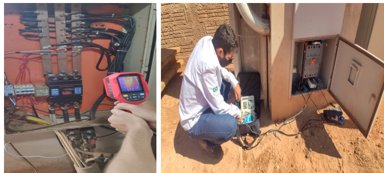
(a) Análise Termográfica (b) Configurando analisador de Energia
